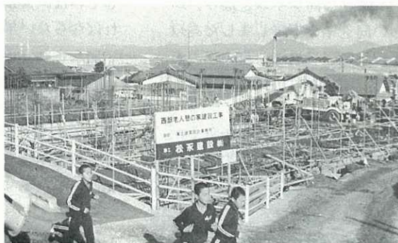
▲西部老人憩の家建設 老人福祉を増進するため山代町久原に4月オープンを目指し建設中です。
