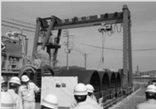
第4工業用水道建設事業 久原南ふ頭の海底に埋設される管
