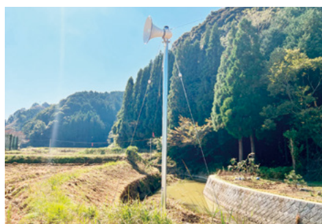
↑ 新しく整備した有線放送設備
