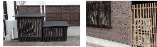
木調の囲いで見えにくくした室外機【他都市事例】
