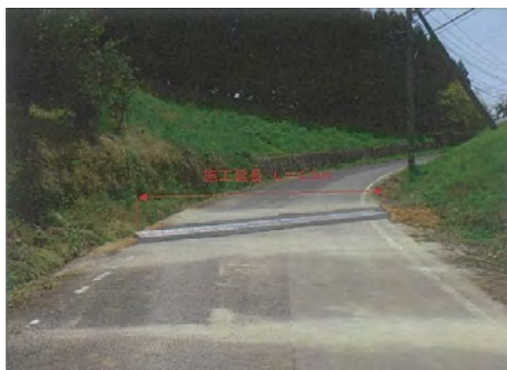
【市道水留・重橋線】
