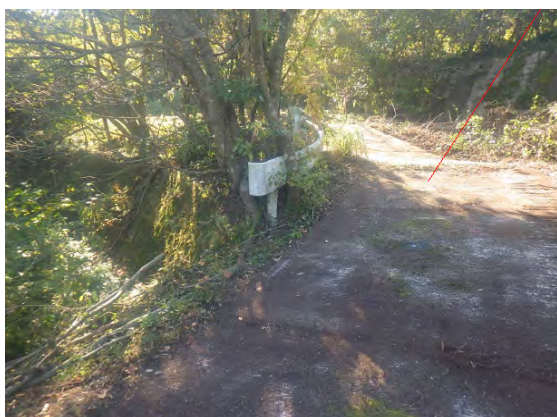
大久保地区農道陥没状況
