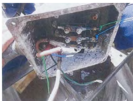
【クーリングタワー 破損箇所 修理前】
