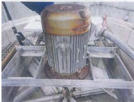
【クーリングタワー モーター 修理前】
