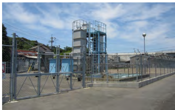
浦ノ崎浄水場
