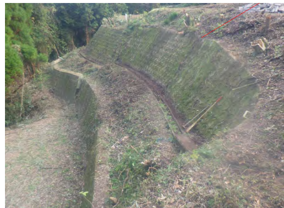
大久保地区擁壁被災状況
