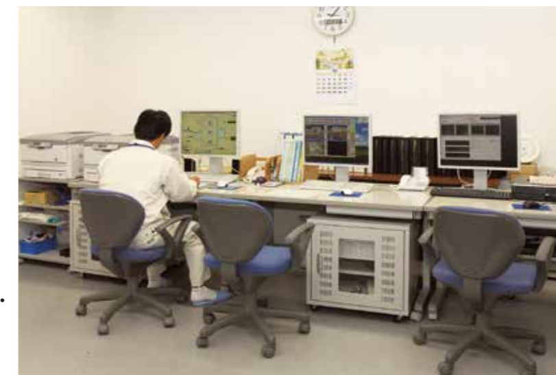
大川浄水場監視室
