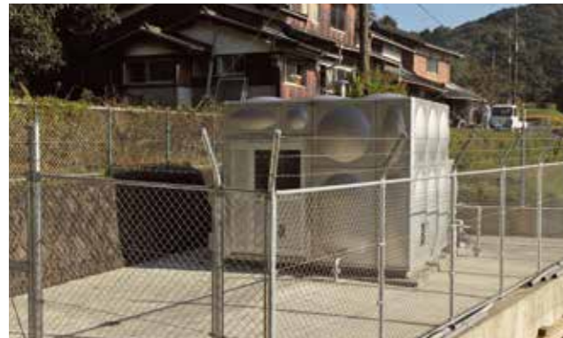
屋敷野送水ポンプ場
