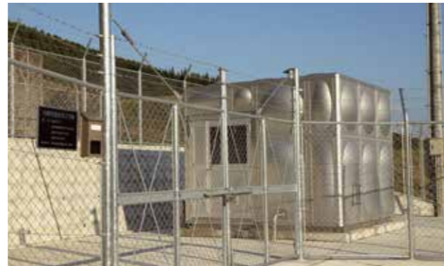
大野岳送水ポンプ場
