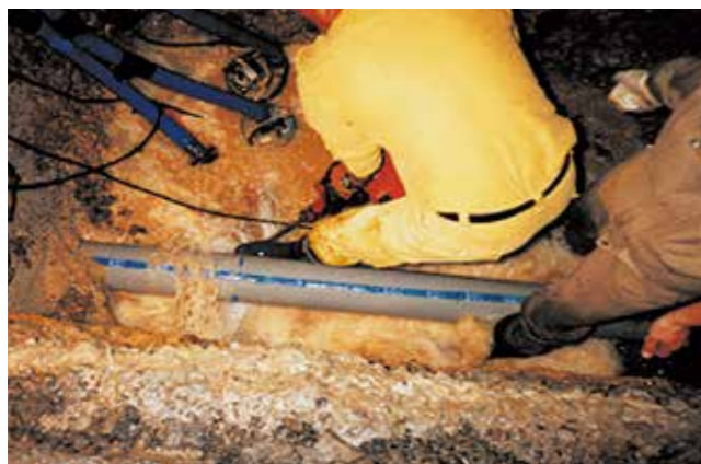
VPφ100mmが防護不備により破損
