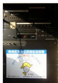
↑駒鳴区に整備された放送設備
