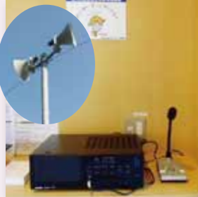
↑東山代町浦川内公民館に整備された放送設備
